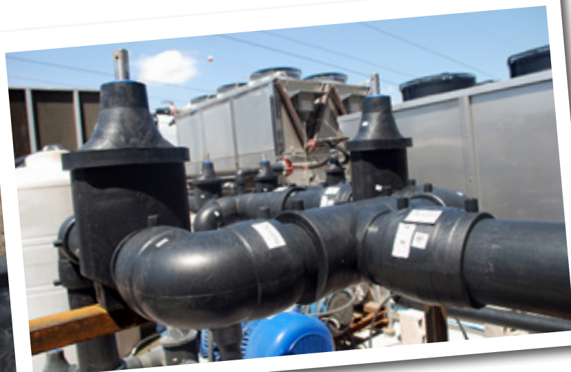
Турция - система охлаждения Turkey - Cooling System
