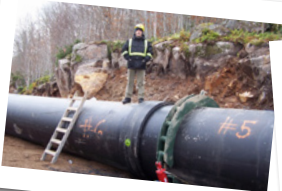
Канада, Халифакс - установка электросварной муфты диаметром 1600 мм - крупнейшей в мире! Canada Halifax - D1600 EF Coupler Application. The Biggest EF Coupler on The World!
